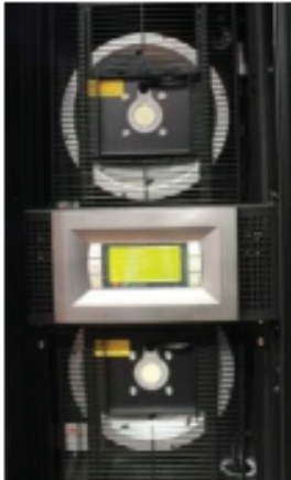
Aire Acondicionado de Precisión con panel de configuración
