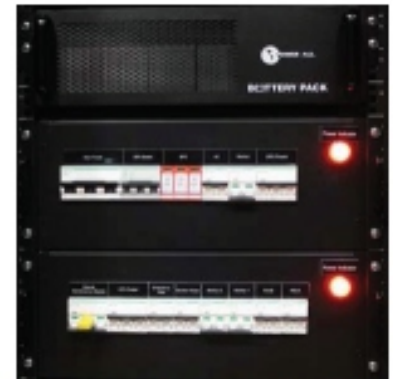
Módulos de distribución de energía
