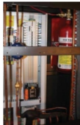
Sistema contra incendio
