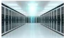
Grandes salas de servidor
