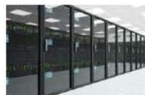
Centros de datos de alta densidad de calor
